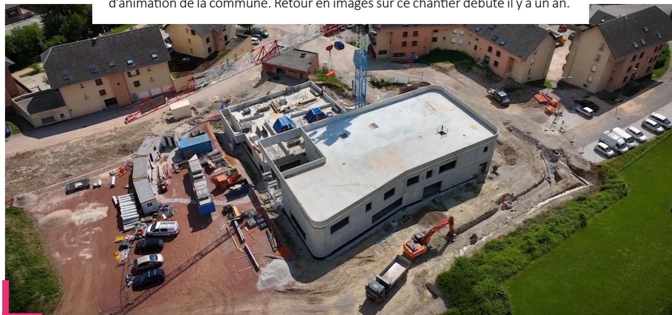
Situé au centre du nouveau Cœur de vie, L'Esquisse, espace dédié aux synergies citoyennes, impactera favorablement la dynamique associative, culturelle et d'animation de la commune. Retour en images sur ce chantier débuté il y a un an.
